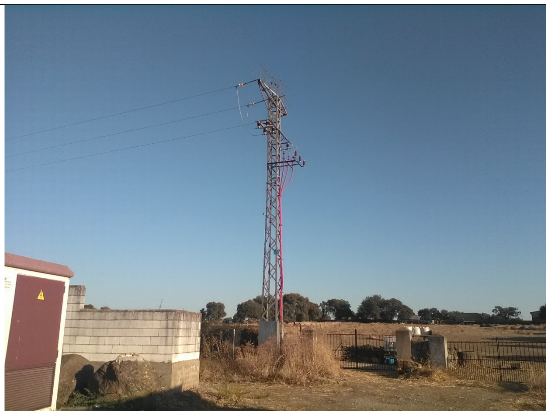
Apoyo existente nº 2022 (1)
