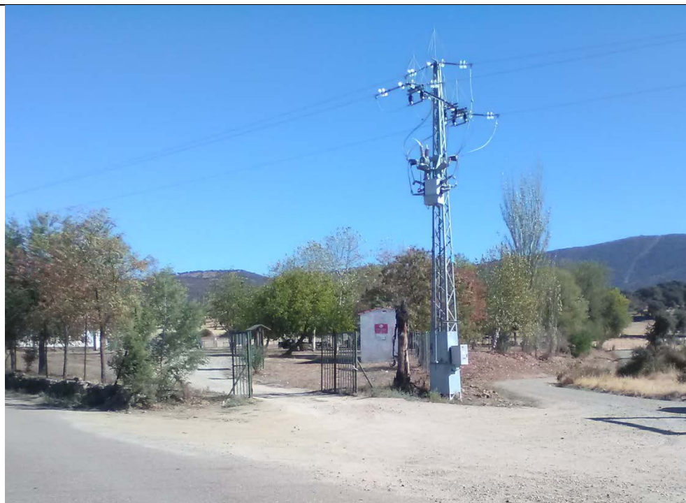
Apoyo existente nº 9006
